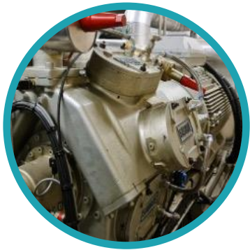
Varmepumpe som primær varmekilde
